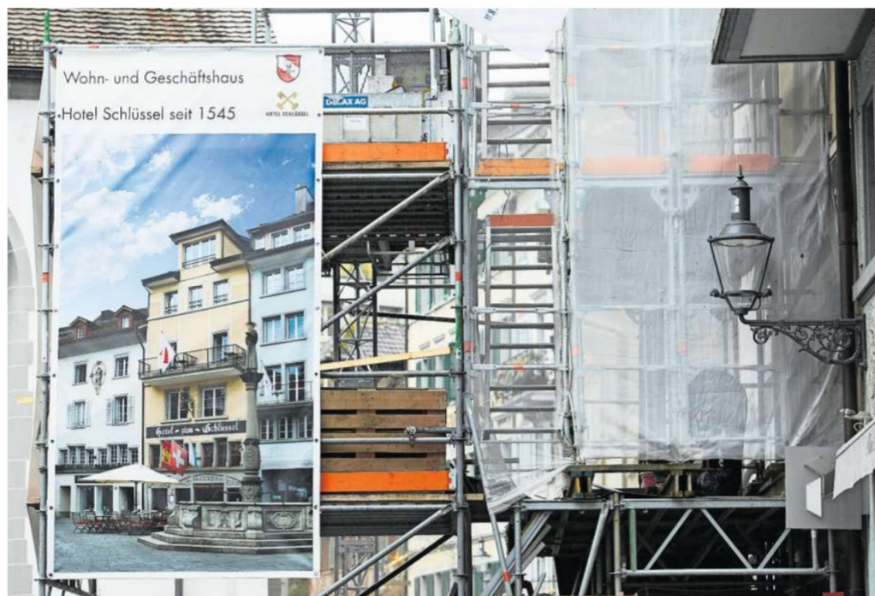
Das Hotel Restaurant Schlüssel musste nach dem Brand totalsaniert werden.
